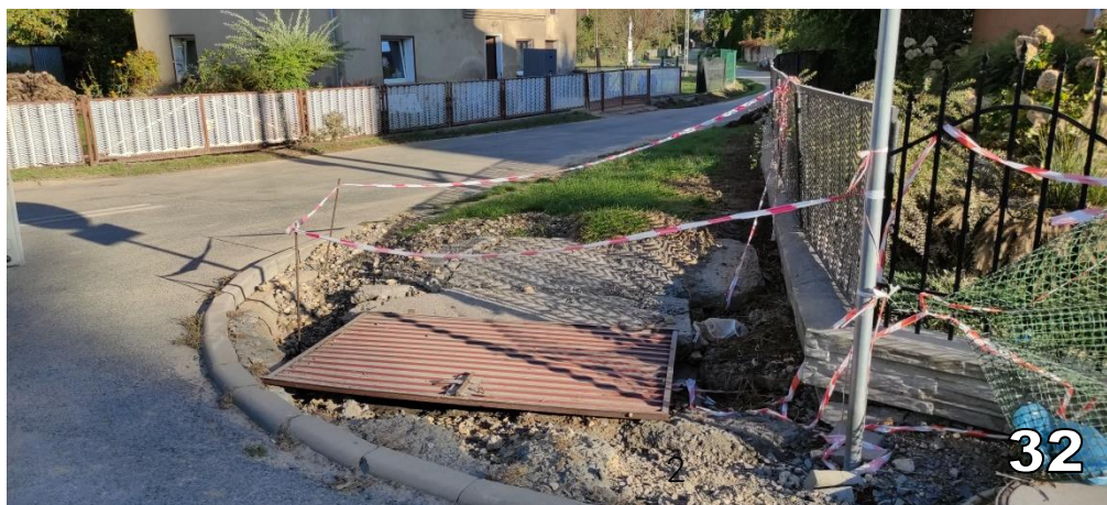
Niemysłówce kolektor deszczowy, pobocza dróg (zdj. 32-34)
